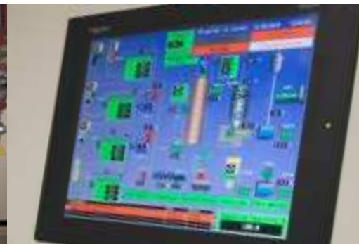
Pannello di controllo dell'impianto di saponificazione.
