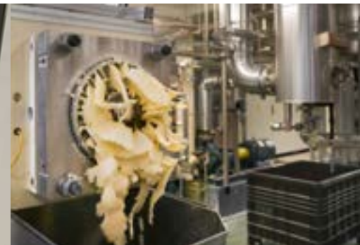
Trafila di estrusione dell'impianto di saponificazione.
